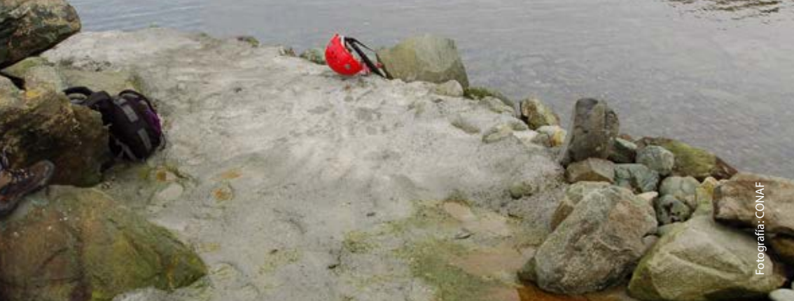
Intervención ilegal hecha con hormigón en borde costero de Parque Nacional Kawésqar.
