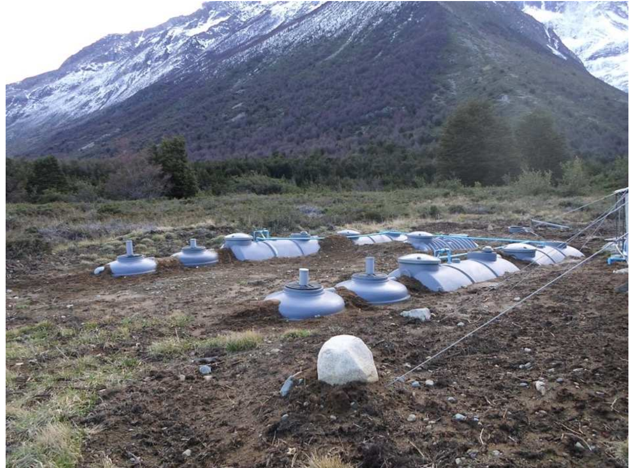
Plantas de tratamiento de aguas servidas
